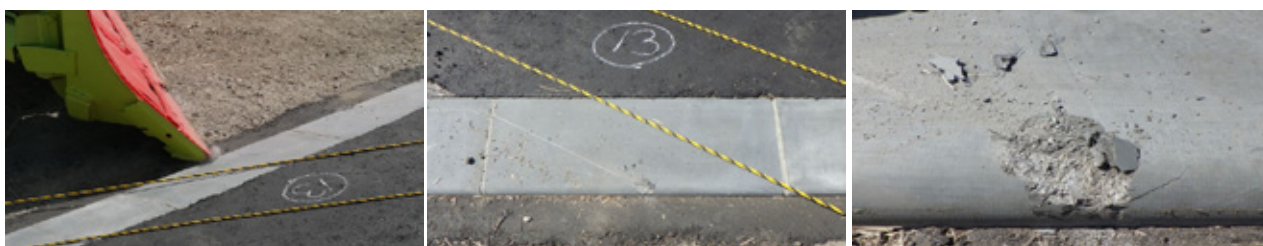
写真-4 除雪ドーザ試験による損傷状況 (左：接触状況、中：斜面上に付いた傷、右：欠損状況)
