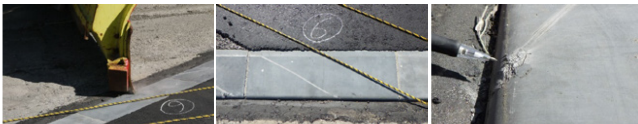
写真-3 除雪グレーダ試験による損傷状況 (左：接触状況、中：斜面上に付いた傷、右：欠損状況)
